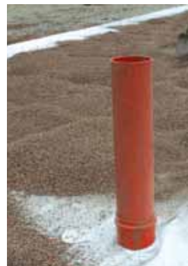
Наземная часть инспекционной трубы диаметром 200мм
