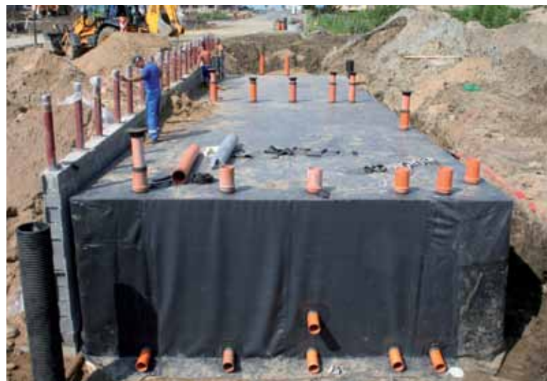
Буферный резервуар в дренажной системе
